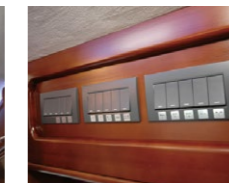
エントランスドア上部に室内電源の集中スイッチ
