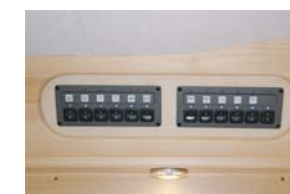
エントランスドア上部に室内電源の集中スイッチ
