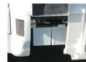
エントランス横のメイン&amp;サブバッテリー
