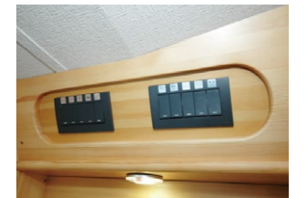
エントランスドア上部に室内電源の集中スイッチ
