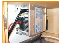
バッテリーチャージャー
