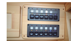
エントランスドア上部に 室内電源の集中スイッチ
